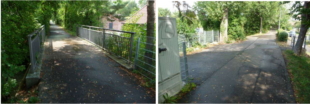
Abbildung 19: Brücke über den Heergossenbach, Blickrichtung Lichtenstein (links), Steuerschrank der Wehranlage und Standplatz an der Trasse, Blickrichtung Pfullingen Bahnhof (rechts).
